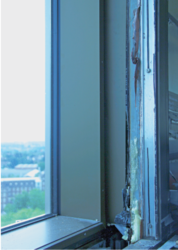
Die Laibung des neuen Fassadenelements wird später nach innen erweitert. Hier ist noch die Demontage des alten Rahmens erkennbar.
