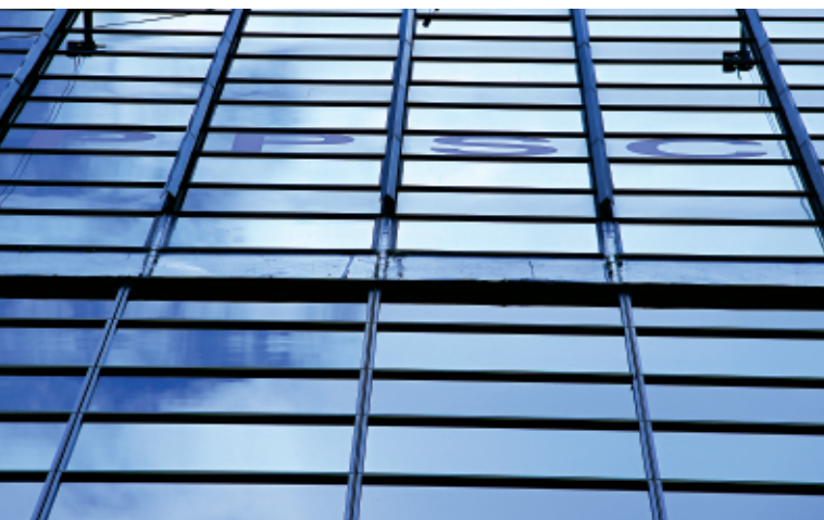
250 mm ragen die neuen Fassadenelemente weiter nach außen. Aufgrund des Spalts musste sofort provisorisch gegen Regen abgedichtet werden.
